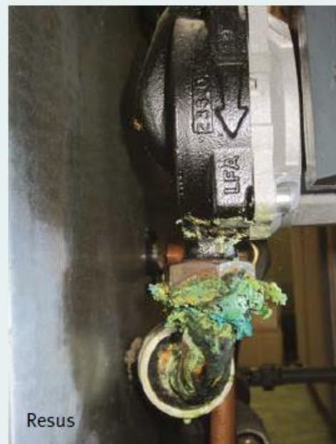
C. Schuimvormige uitbloeiingen op de flenzen van een pomp
