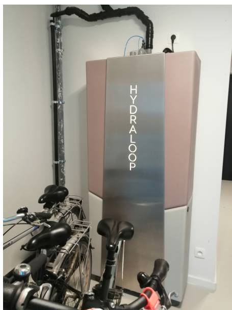
FIGURE 4.2 – Système « Hydraloop » de réutilisation des eaux grises (Photo de l'auteur)
