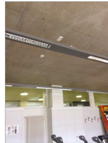
CO 2 et temp. local
