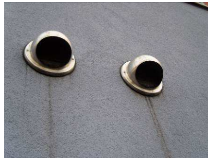
Prise d'air prévue et placée
