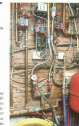
Links: Een voorbeeld van 'vondere installatiech-niek'. In de installatie van deze vijf jaar ouder staat op minder dan een meter drie kleine automatische ventielen, een direct expansievat, twee manometers en elektrische leidingen. Merk op dat de twee manometers sterk verschillende waarden aangeven, volgens andere gegevens, dat de elektrische aansluiting kan fouten. Deze installatie is jammer genoeg geen uitzondering.
